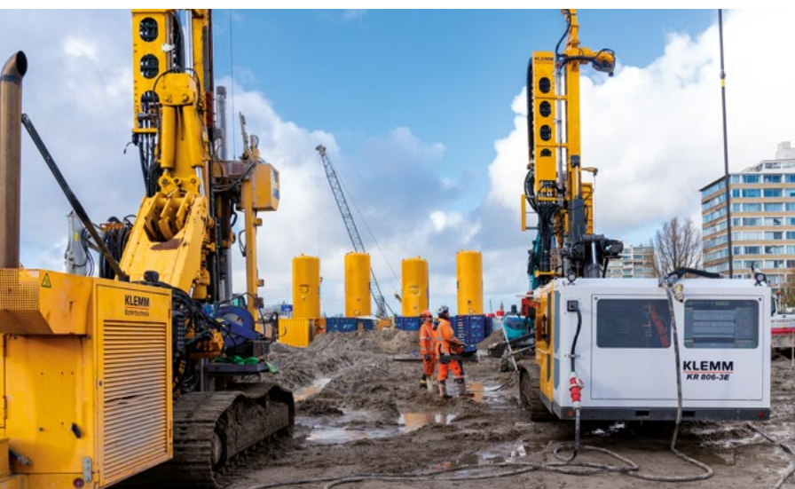
Das elektrische Ankerbohrgerät KLEMM KR 806-3E überzeugte im direkten Vergleich auf der Baustelle.
