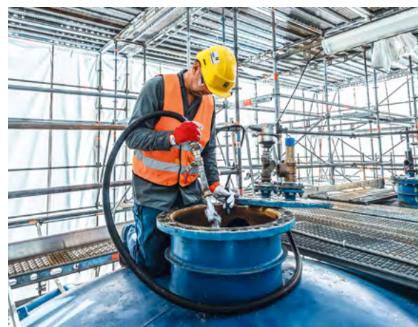
Bauer Resources realisiert Grundwasserreinigungsanlagen von klein bis groß.
