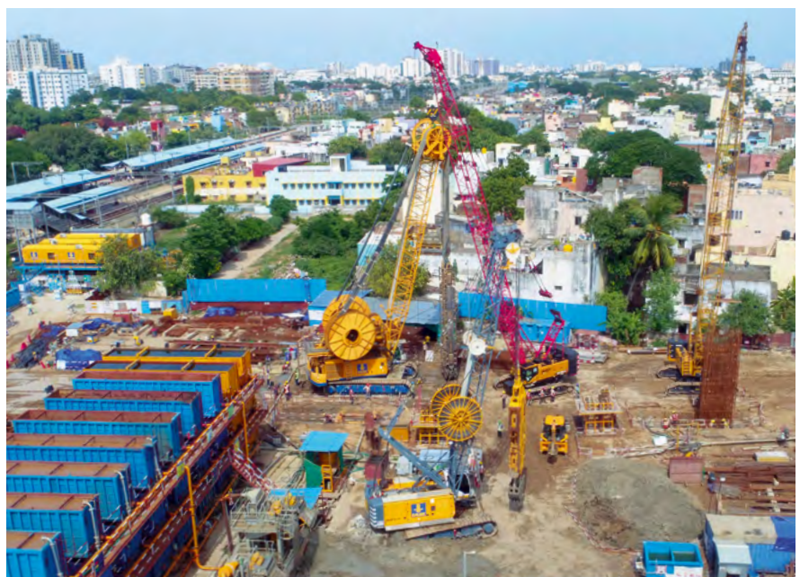
Auch in der indischen Stadt Chennai ist Bauer am Metro-Ausbau beteiligt. Über 15.000 m 2 Schlitzwand wurden für die Chetpet Metro Station hergestellt.
