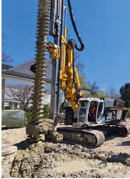
Ein Münchener Projekt der Bauer Spezialtiefbau, an dem auch Bauer Resources beteiligt war, erhielt das DGNB-Zertifikat für nachhaltige Baustellen.
