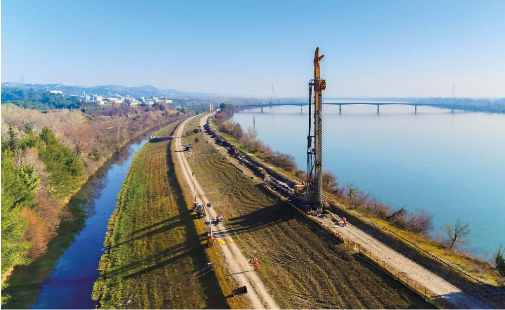
Zur Sanierung eines Deiches an der Rhone in der Provence wurde eine Mixed-in-Place-Wand hergestellt. Der Transport von Baustoffen konnte aufgrund des eingesetzten Verfahrens auf ein Minimum reduziert werden.
