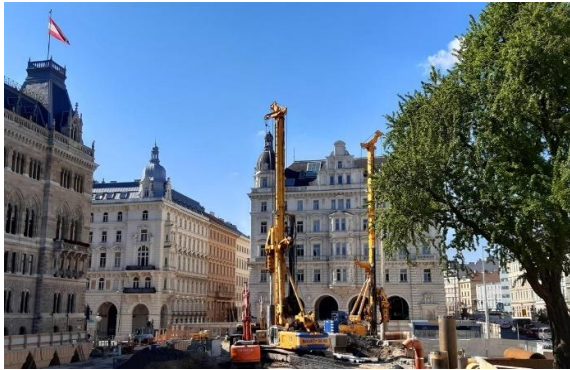
(1) Eine BAUER BG 45 und eine BG 40 bei den Bohrarbeiten für den U2/22 Schacht Friedrich-Schmidt-Platz.
