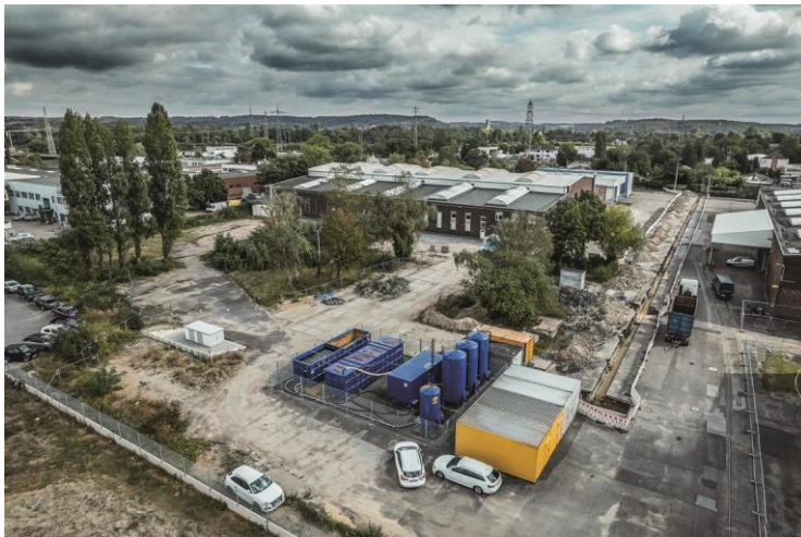
(1) Die Bauer Umwelt-Grundwasserreinigungsanlage reinigt stündlich 12,5 m 3 belastetes Wasser.
